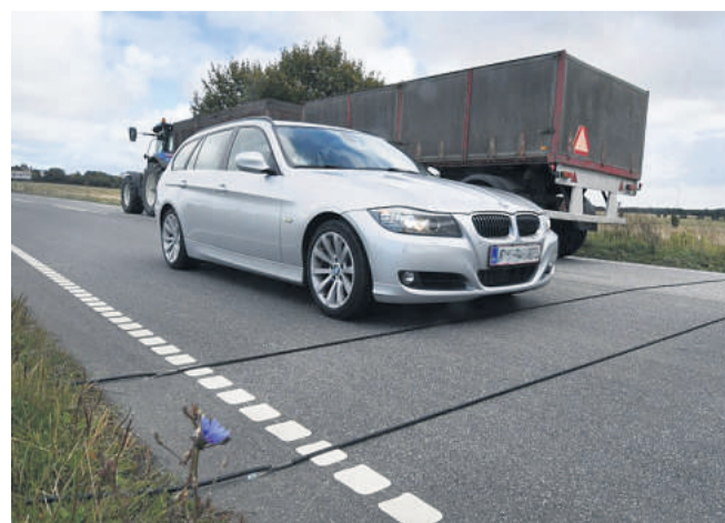
Her er det på Maribovej ved Halsted ved indkørslen til Rute 9, at der er lagt kabler ud. Foto: Jan Knudsen
